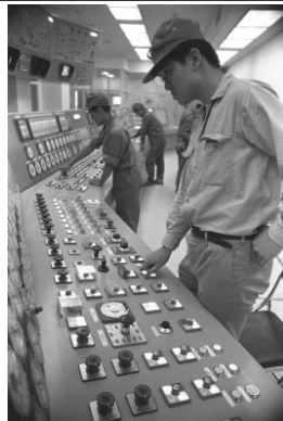
環境事業局港南工場(港南区)
