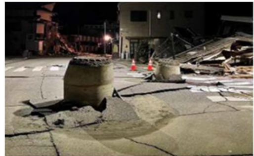
<マンホール浮上（輪島市）>
