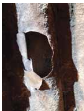
ボイラ水管穴あき詳細
