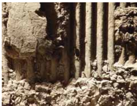
焼却工場 穴の開いたボイラ水管
