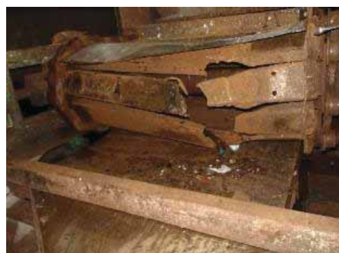
資源選別施設 老朽化したコンベヤ
