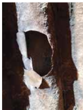
ボイラ水管穴あき詳細
