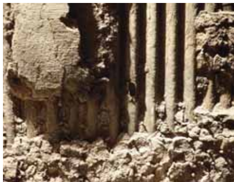
焼却工場 穴の開いたボイラ水管
