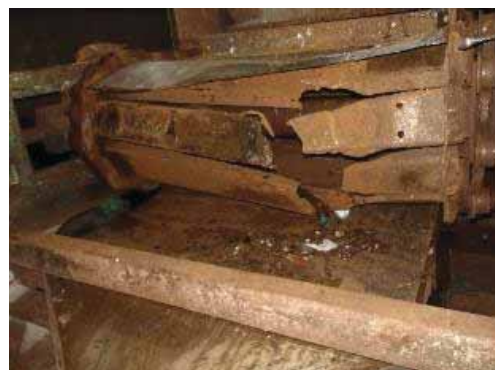
資源選別施設 老朽化したコンベヤ
