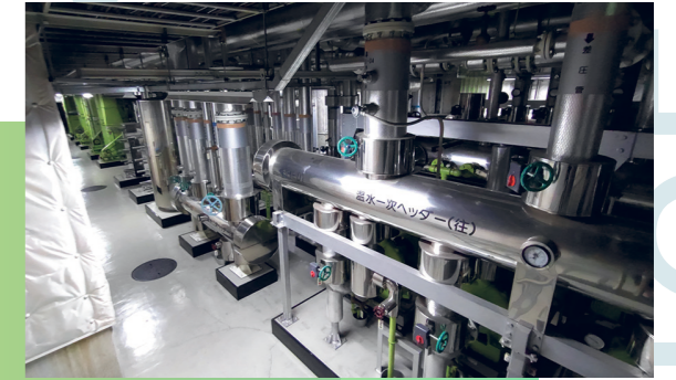
機械室の様子
