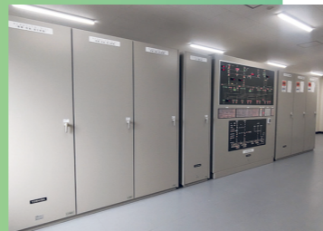
更新した電気盤
