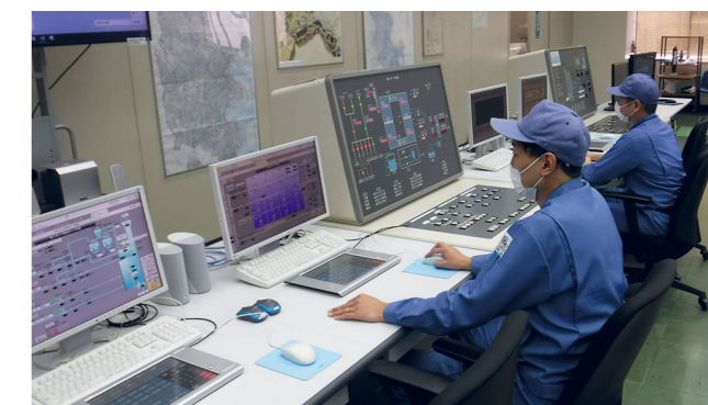
下水道施設を監視している様子
