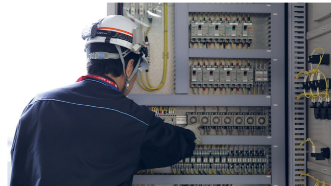
電気設備(配電盤)更新後の確認
