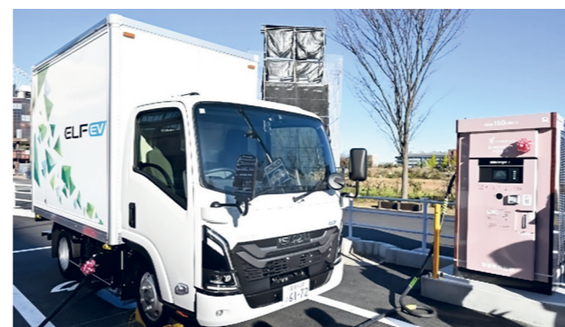
EV充電器の公道設置
