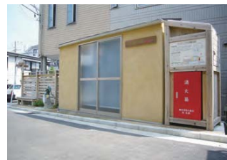
地下貯水槽と手押しポンプ
