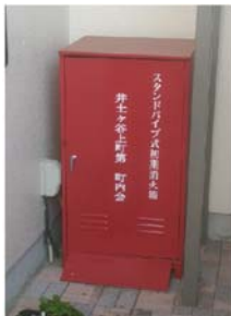
スタンドパイプの配備
