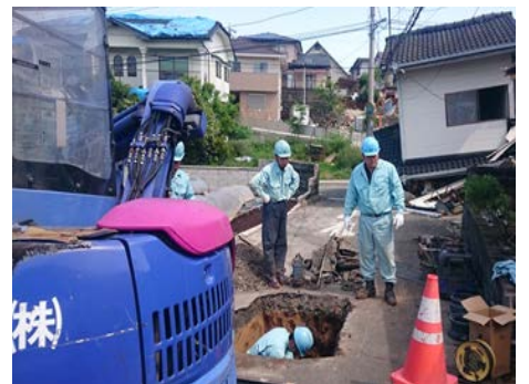
平成 28 年熊本地震で水道管の漏水修理をしている組合員の様子（熊本県益城町）
