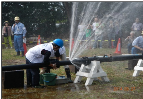
破裂した配水管修繕訓練 （横浜市管工事協同組合による実演）
