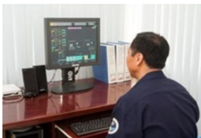
アズビル株式会社 フエ省水道公社の浄水場に導入した SCADA システム
