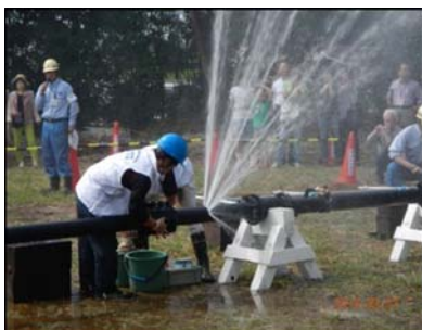
〈配水管の破裂状況〉
