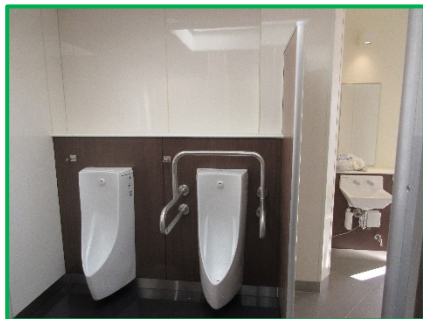
【横浜駅東口駅前広場公衆トイレ 小便器】
