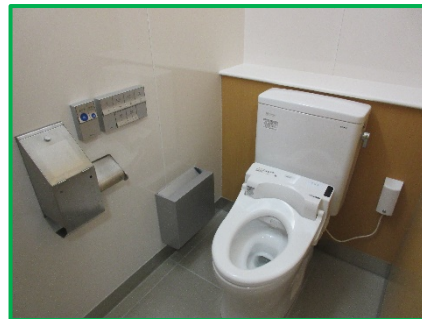
【横浜駅東口タクシープラザ公衆トイレ 大便器】
