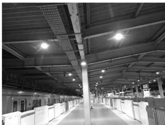
<駅のLED照明>
