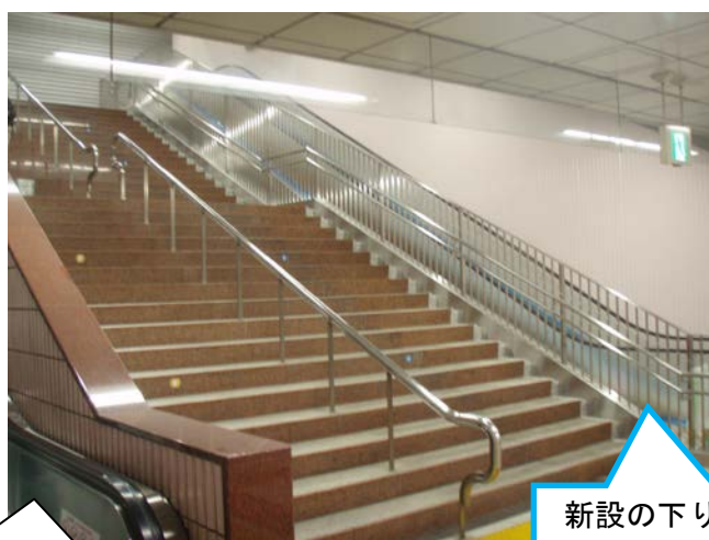
既設の上りエスカレーター
