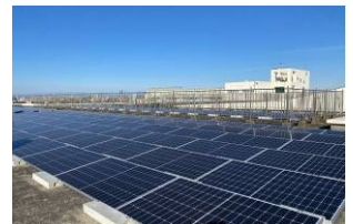
公共施設の太陽光発電設備
