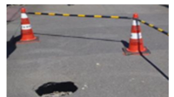
取付管破損による道路陥没
