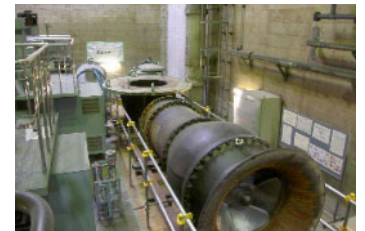
汚水ポンプの長寿命化
