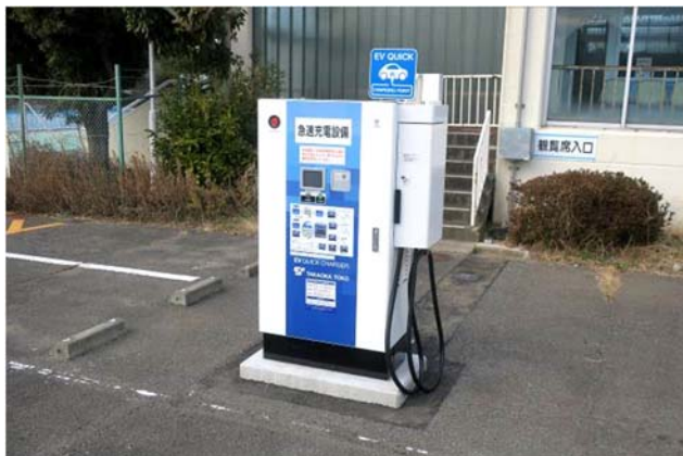
急速充電設備
