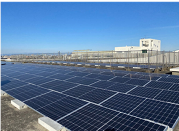
太陽光発電設備
