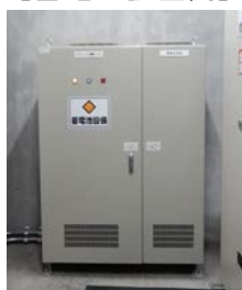
【蓄電池設置例】
