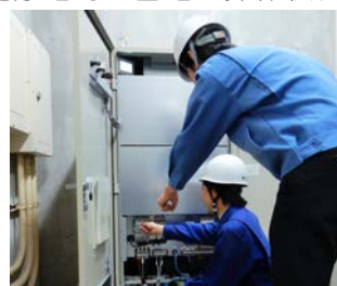
【停電時の蓄電池操作状況】
