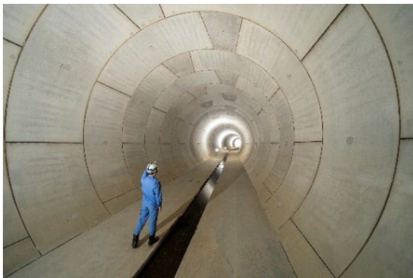
新羽末広幹線（下水道施設） 施設容量：410,000 \text{m}^3
