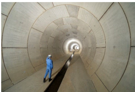
新羽末広幹線（下水道施設） 施設容量：410,000 m 3
