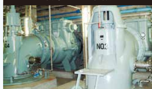
雨水ポンプ施設
