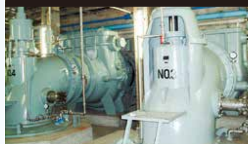
雨水ポンプ施設
