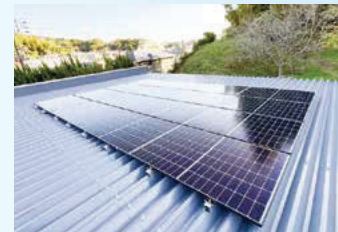
▲町内会館に設置した太陽光パネル
