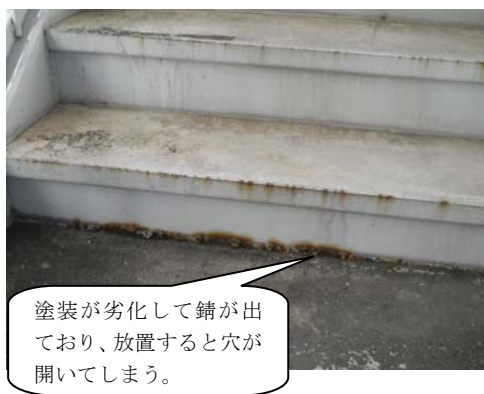
屋外階段の塗装劣化状況
