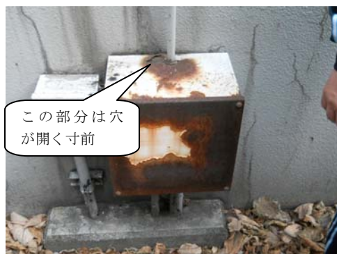
屋外電気接続箱の塗装劣化状況
