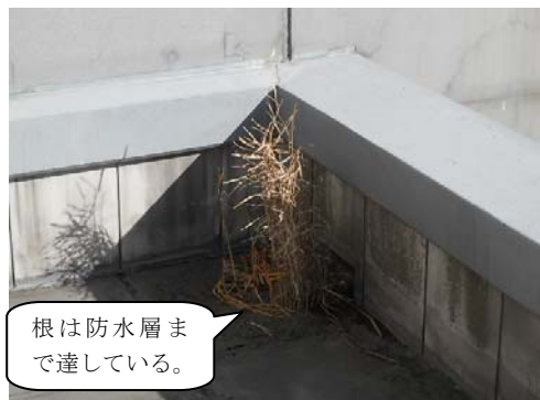
雨水排水口部分の雑草
