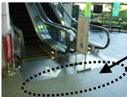
(青葉区庁舎 エスカレーター)
