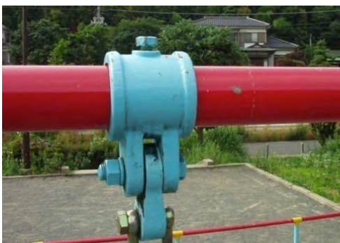
図 2-2 5 吊金具を1本のボルトで梁に押し付けて固定している例 ボルトが緩みやすく、吊金具がずれる。
