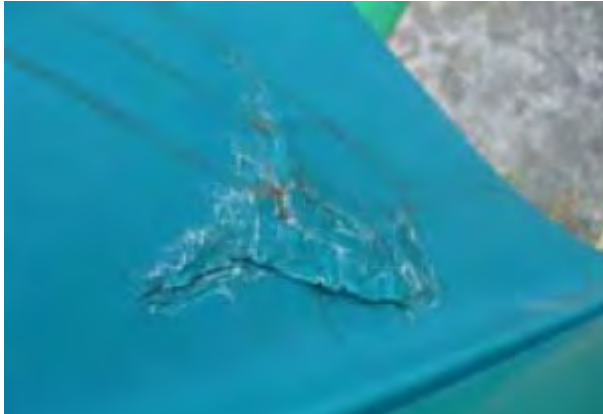
図 2-9 FRP 破損の例
