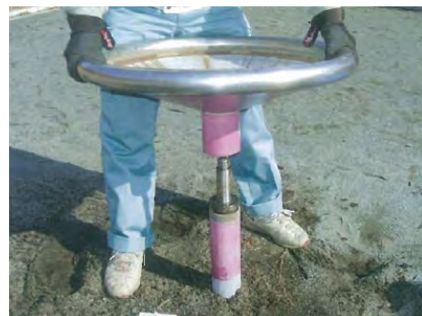
図 2-1 6 回転遊具・点検作業中② 柱脚部：さらに下部カバーを外す。
