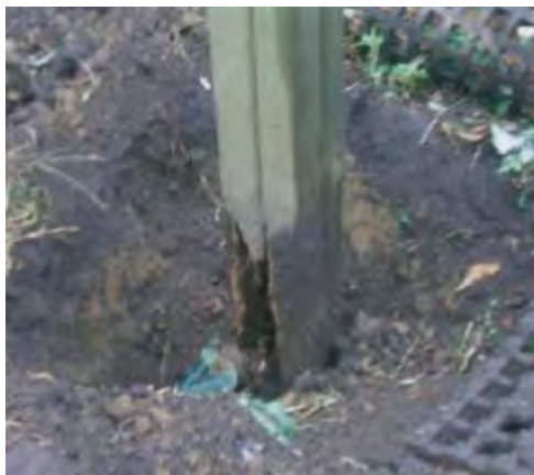
図 2-7 腐食した木材
