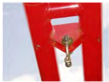
図 2-2 4 吊金具が梁に溶接されている例 溶接部に亀裂が入った例あり。揺動部も華奢で交換頻度も高い。
