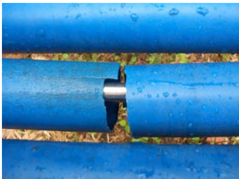
図 2-18 ローラー破損の例①
