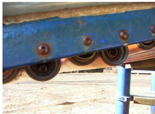
図 2-19 ローラー破損の例②
