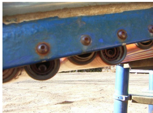
図 2-19 ローラー破損の例②
