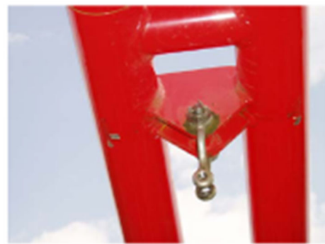
図 2-2 4 吊金具が梁に溶接されている例
