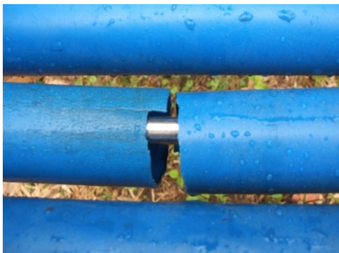
図 2-18 ローラー破損の例①
