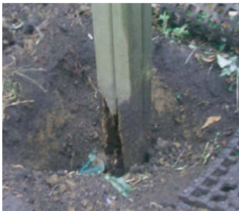
図 2-7 腐食した木材
