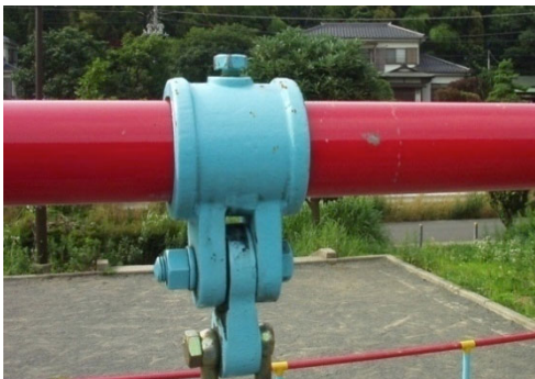
図 2-2 5 吊金具を1本のボルトで梁に押し付けて固定している例
