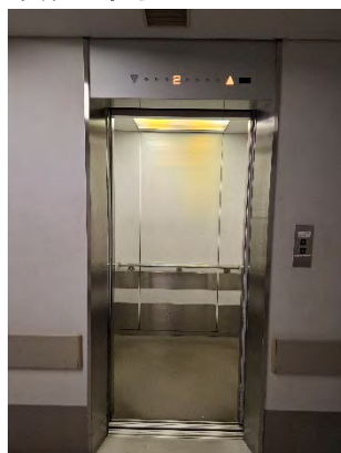
外観（開扉状態）
