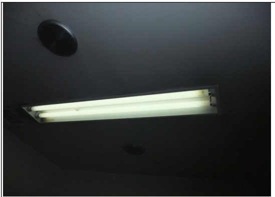
トイレ②_障害者用_照明.jpg
