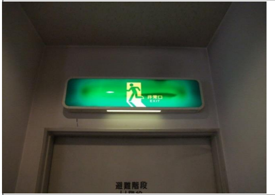
ロビーエレベーター近く誘導灯.jpg
