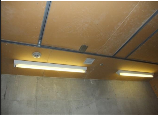
倉庫⑦-2_照明②.jpg 123
