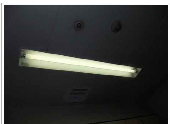
給湯室①_照明②.jpg
