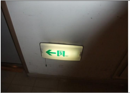
搬入口廊下_誘導灯.jpg
