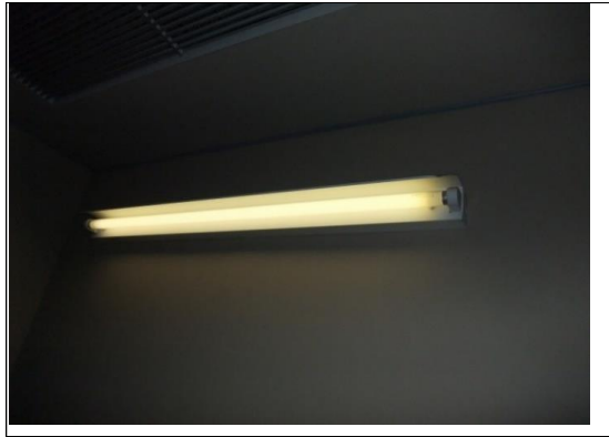
大ホール調整室下_階段裏_照明②.jpg
