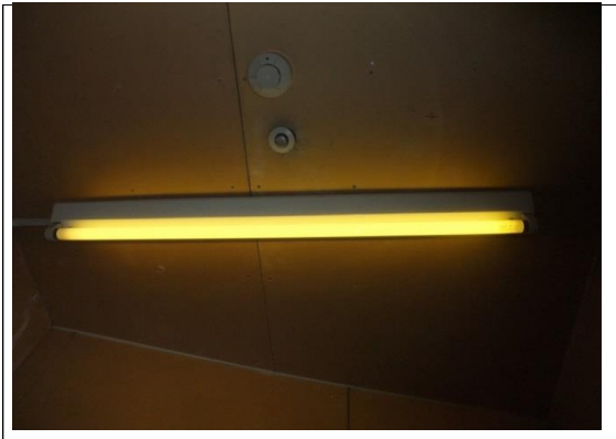
倉庫⑦-1_照明②.jpg 122
