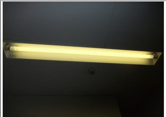
給湯室③_照明.jpg
