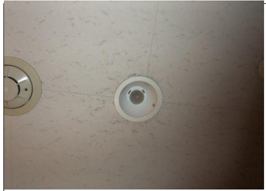
上手裏出口_非常灯.jpg 44
