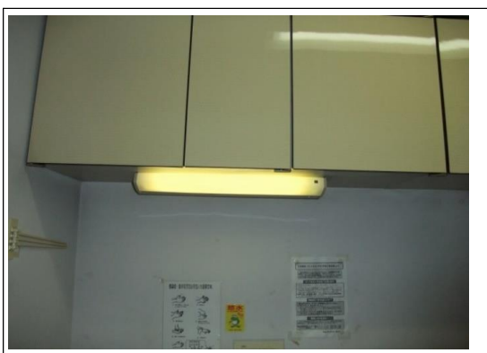
給湯室①_照明.jpg
