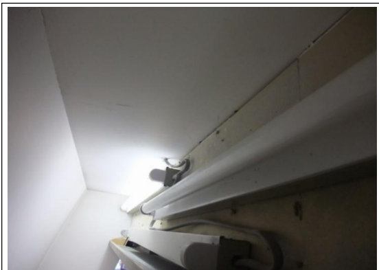
ロビー_照明③.jpg
