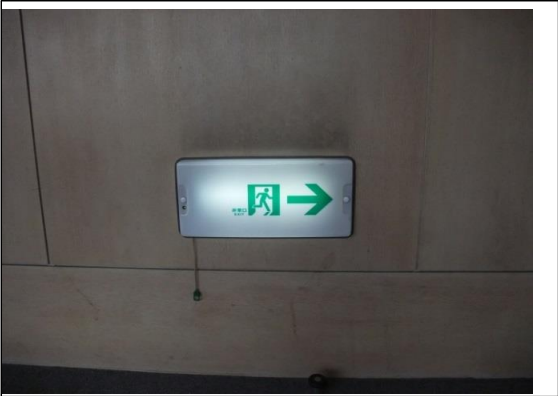
カルチャー工房側廊下_誘導灯②.jpg 98
