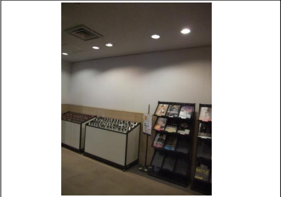
カルチャー工房側廊下_照明②.jpg 94
