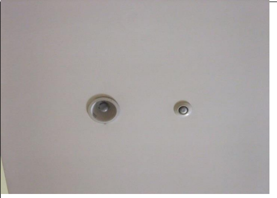
ロビー_非常灯.jpg
