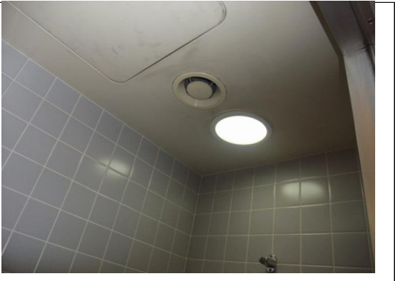
カルチャー工房更衣室側_シャワー_照明②.jpg 113
