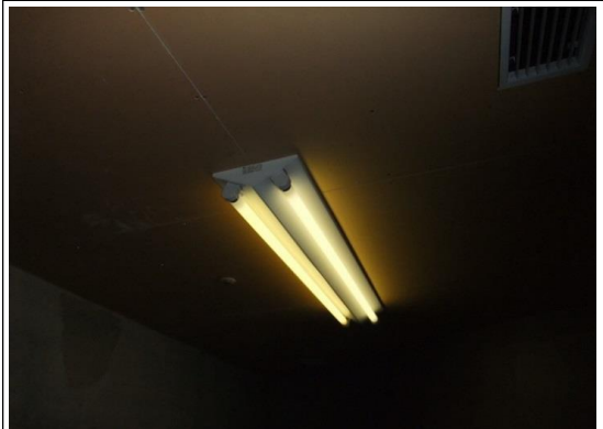
倉庫①-2_(小部屋)_照明.jpg
