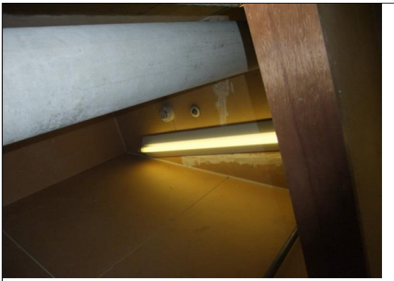
倉庫⑦-1_照明.jpg 122
