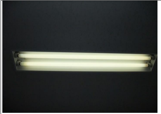
事務室_照明.jpg
