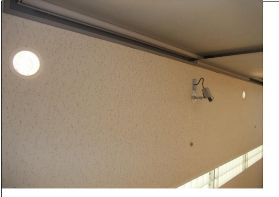
カルチャー工房_照明②.jpg
