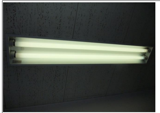
搬入口廊下_照明.jpg
