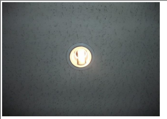
カルチャー工房更衣室側_照明.jpg 115
