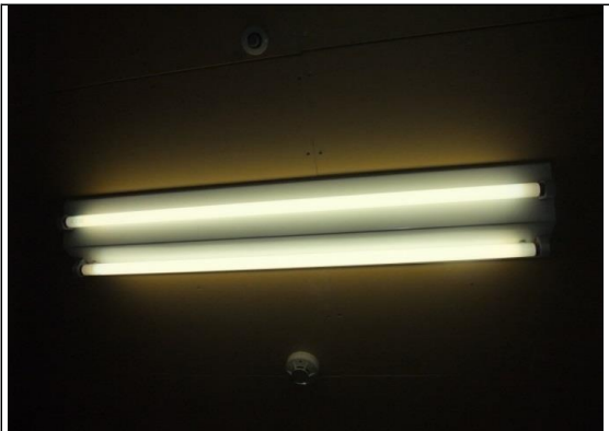
倉庫⑥_照明.jpg
