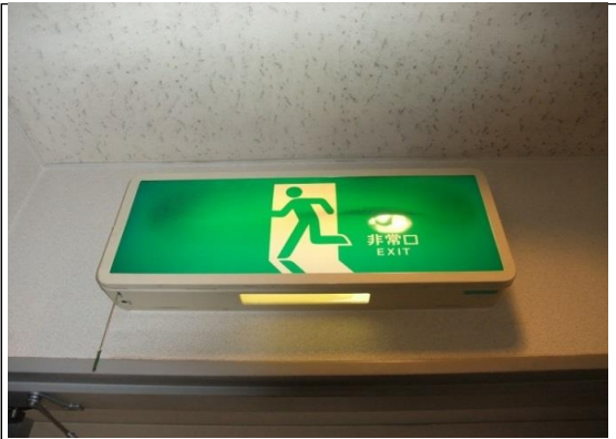
カルチャー工房更衣室側_誘導灯.jpg 117
