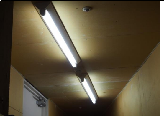
倉庫⑧-1_照明②.jpg 129
