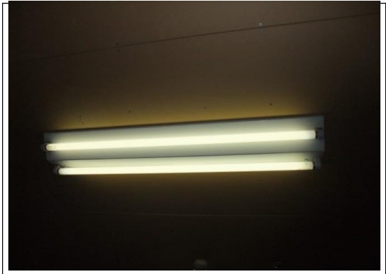
倉庫①-1_(大部屋)_照明.jpg
