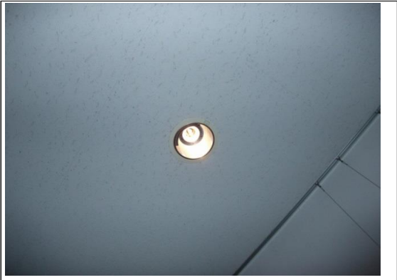
小ホールロビー_丸照明②.jpg
