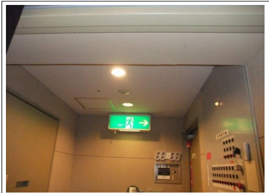
下手裏出口_(大ホール舞台袖)_誘導灯 29
