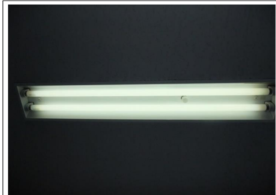
事務室_照明_非常灯あり.jpg
