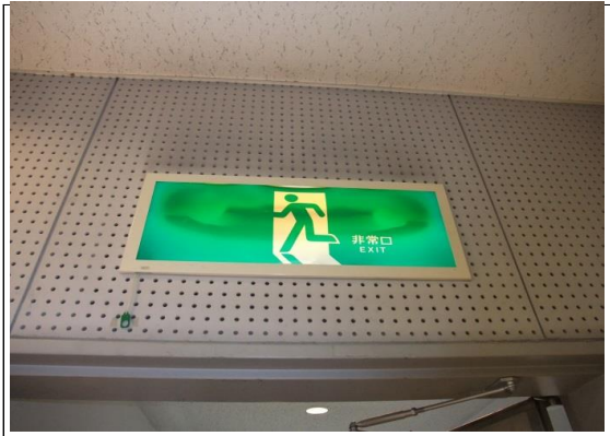
カルチャー工房_誘導灯.jpg 121
