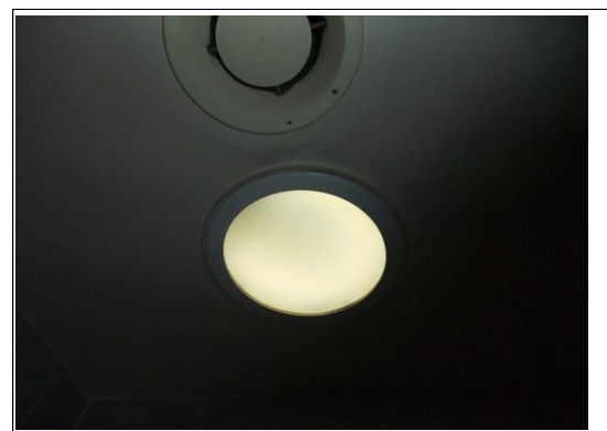
トイレ①_シャワー_照明.jpg
