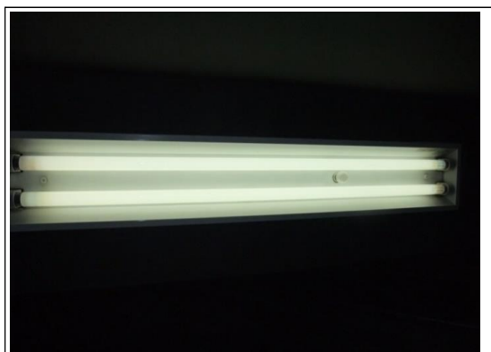
大ホール調整室下_照明②.jpg
