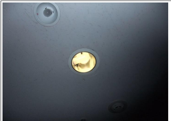
下手裏出口_(大ホール舞台袖)_照明.jp 27、28
