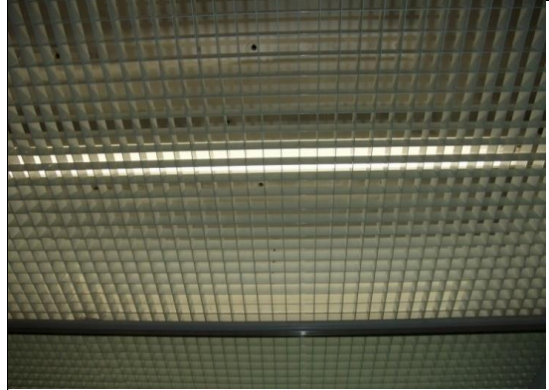
トイレ②_女子_照明②.jpg
