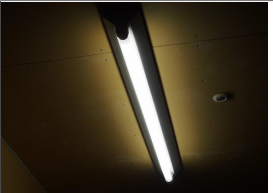
倉庫⑧-1_照明.jpg 129
