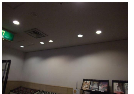
カルチャー工房側廊下_照明.jpg 94
