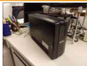
■■■斎場の 無停電電源装置
