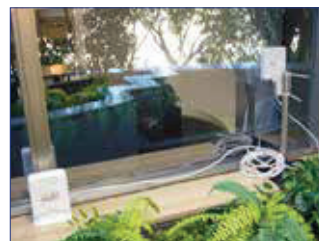
■■■斎場に設置した携帯電話の送受信機
