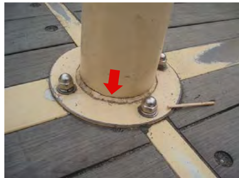
▲ フランジ溶接部の亀裂
