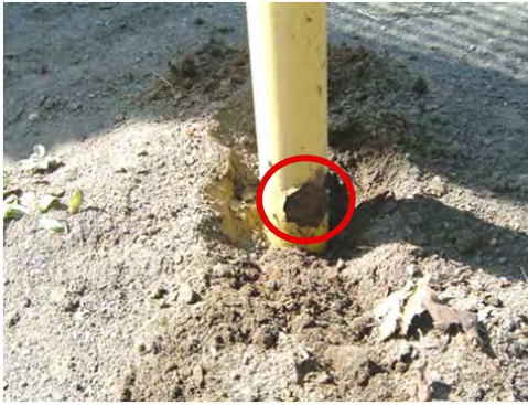
▲ 根際部の腐食（金属柱）
