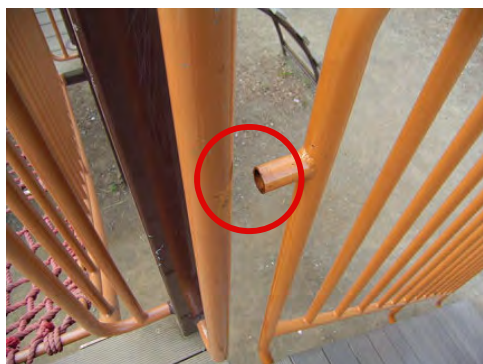
▲ 安全柵取り付け金具の脱落
