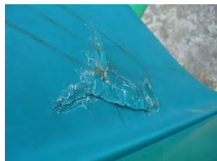
FRPの劣化状況
