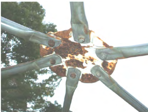
▲ 接続金具の腐食
