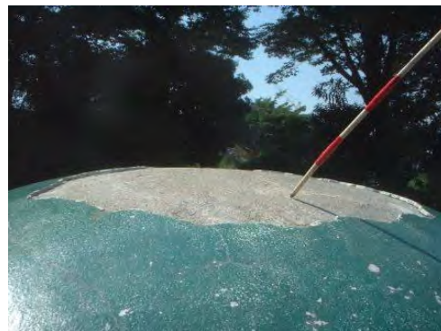
▲ モルタル部の破損
