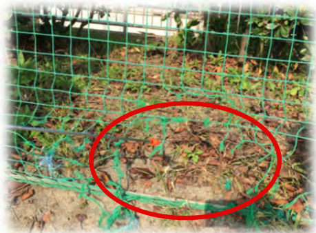
▲ 防球ネット ネット破れ
