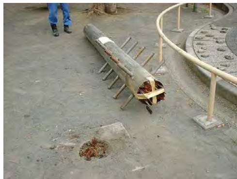
▲ 根際部の腐食による倒壊（木製柱）
