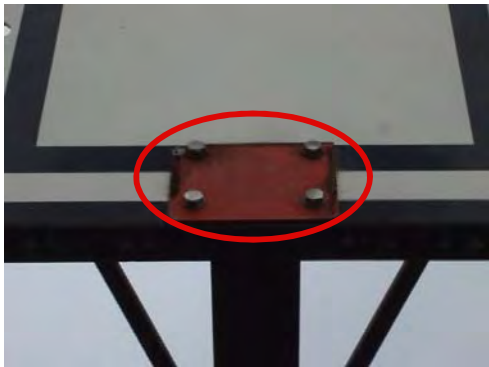
▲ バスケットゴール溶接部の破断
