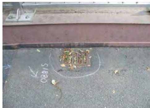
▲ 橋梁の排水施設土砂詰り
