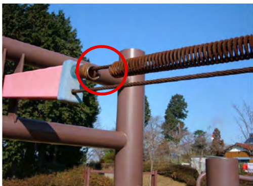
▲ 緩衝部（スプリング）の破損
