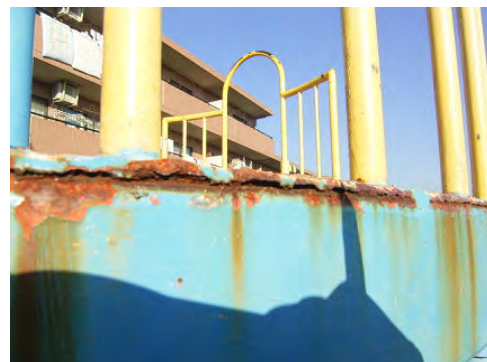
▲ 踏み場の腐食
