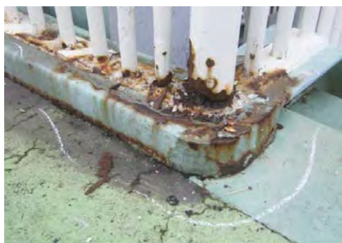
▲ 橋梁高覧（手摺り）の腐食
