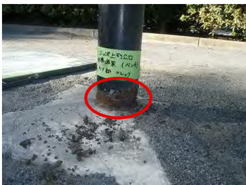
▲ あん馬ベンチ根際部の腐食（鋼製柱）
