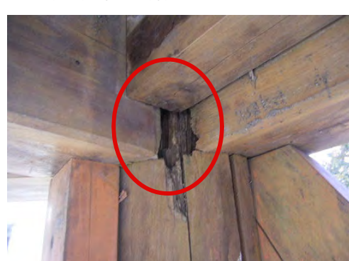
▲ 梁及び支柱の腐朽
