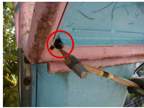
▲ 踊り場の腐食
