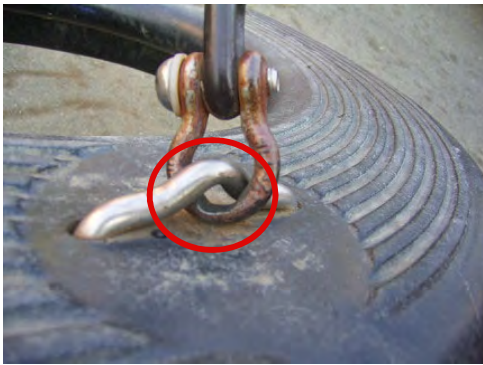
▲ 取付金具の摩耗
