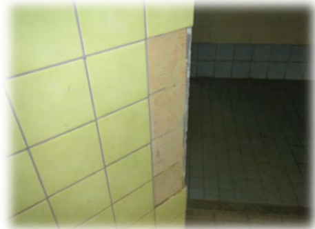
▲ 便所 壁面タイル破損
