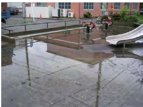
▲ 広場 排水不良
