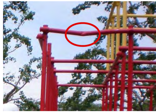
▲ 横部材の変形 (曲がり)
