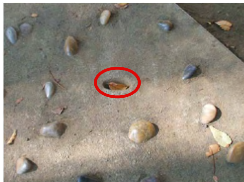
▲ 踏み石の欠落（健康歩道）
