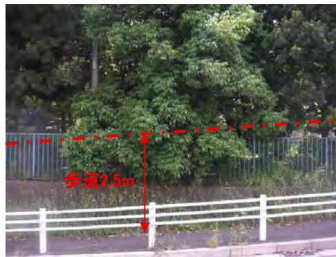
▲ 越境枝・支障枝（歩道建築限界以下の枝）
