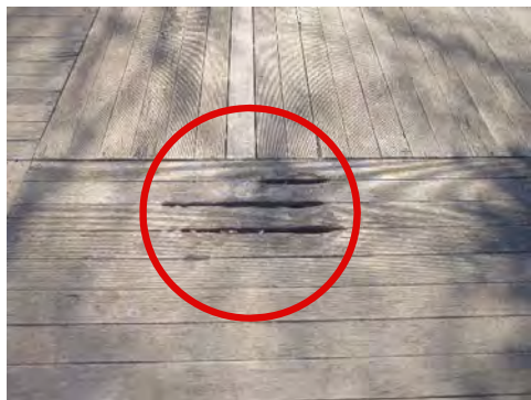
▲ 木製デッキ 床面破損（たき火あと）
