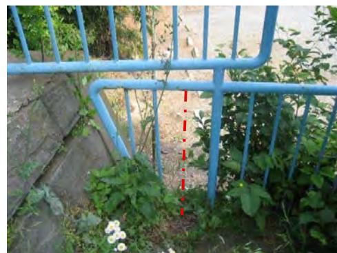
▲ 縦格子柵 部材欠損
