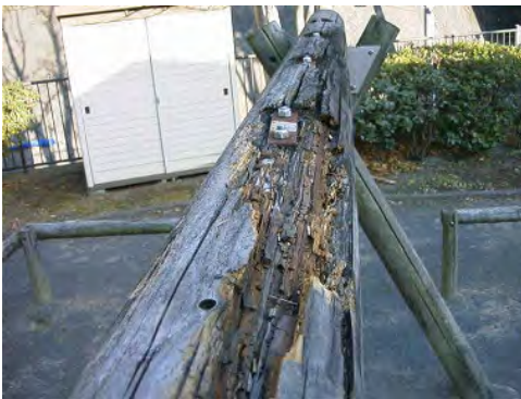
▲ ブランコ梁の腐食（木製）
