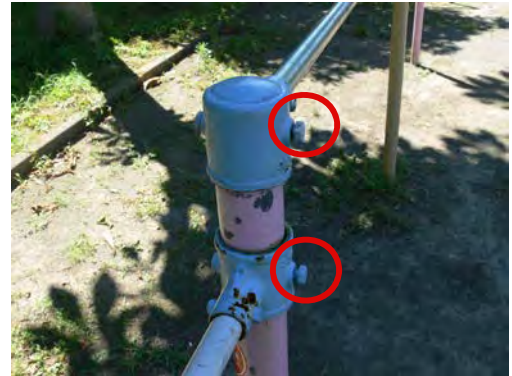
▲ ボルトの飛び出し
