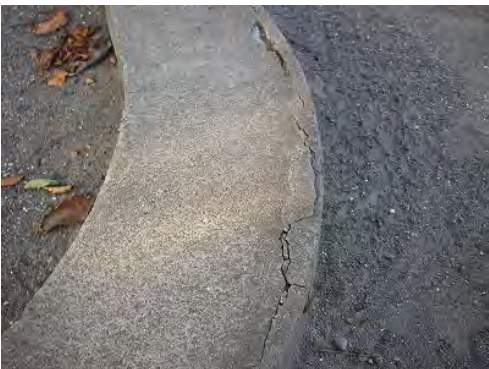
▲ 人研ぎ仕上げの割れ
