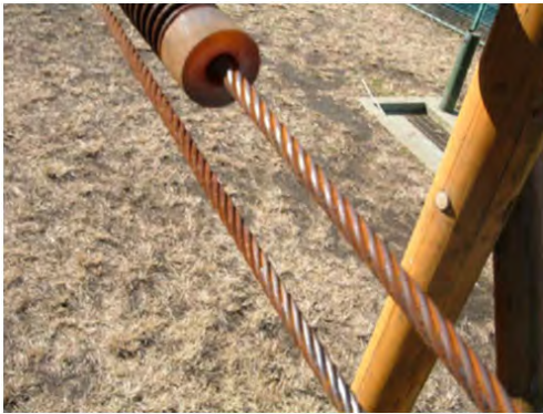
▲ ケーブルの腐食
