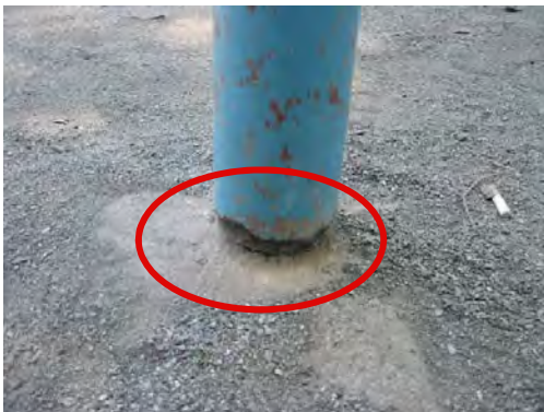
▲ 支柱地際部の腐食及び亀裂
