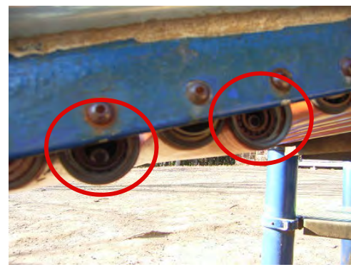
▲ ロールーすべり台のローラー破損
