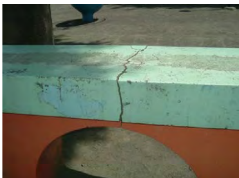
▲ コンクリートの亀裂
