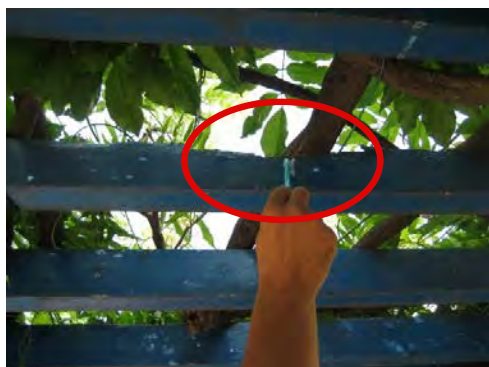
▲ パーゴラ 栈木腐食
