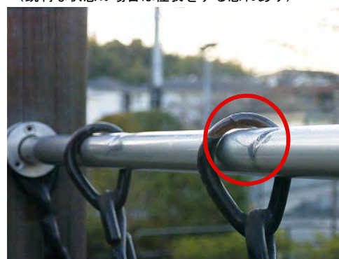
▲ チェーンネット取付金具及びパイプ摩耗
