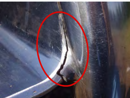
▲ 滑り降り部端部の亀裂
