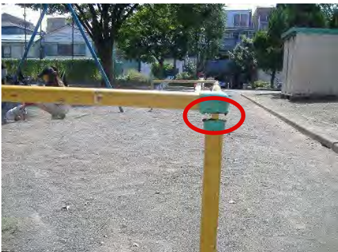
▲ ブランコ安全柵の継手金具の割れ
