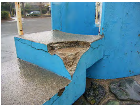
▲ コンクリートの破損
