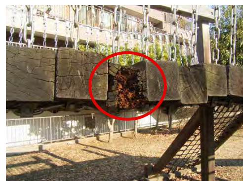
▲ 吊り橋部材の腐朽
