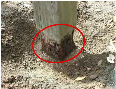
▲ 根際部の腐食（木製柱）
