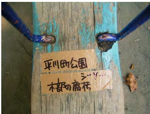
▲ 板の腐朽、取っ手のぐらつき
