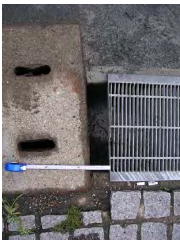
▲ グレーチング 隙間
