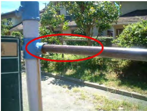
▲ 継ぎ手部分及び握り棒の錆
