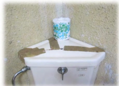
▲ 便所 タンク蓋破損
