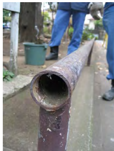
▲ パイプ柵 端部欠損
