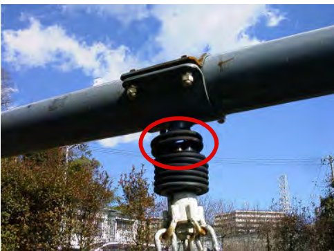
▲ 吊金具カバー破損
