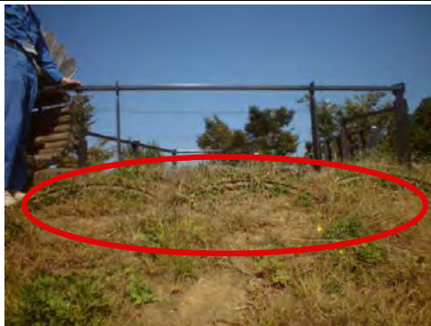
▲ 法面の変状（クラック、法枠金物露出など）
