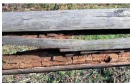
木材の腐朽 (褐色腐朽)
