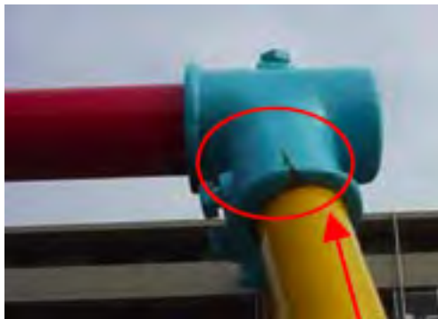
▲ 継ぎ手金具の割れ
