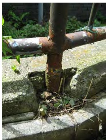
▲ パイプ柵 基礎破損
