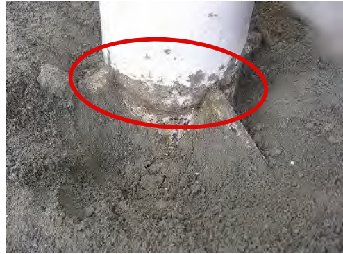
▲ 根際部の腐食及び亀裂
