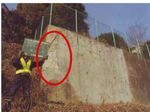
▲ 擁壁表面剥れ
