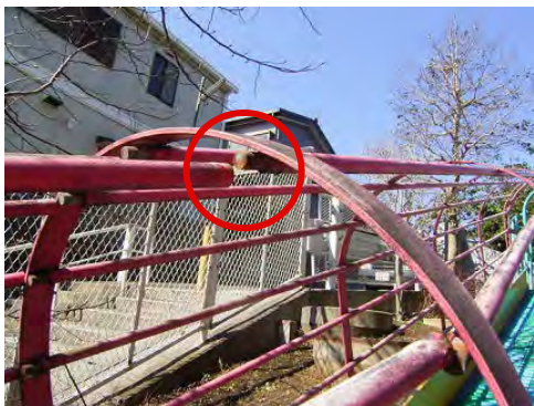
▲ 落下防止柵の接合部の破損
