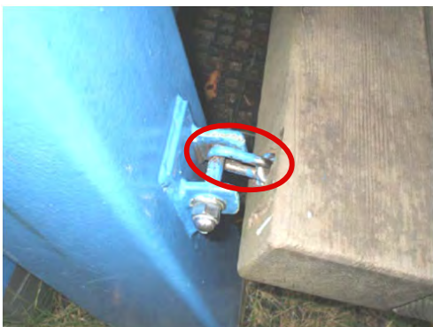
▲ 吊り橋取り付け部チェーンの摩耗
