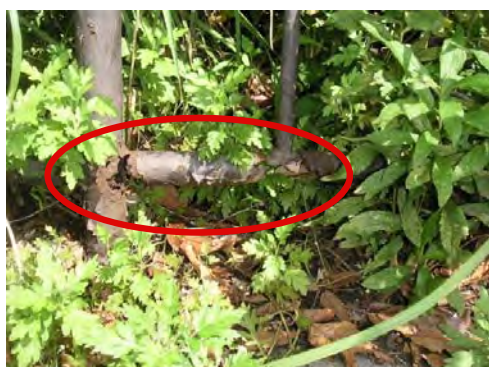
▲ パイプ柵 部材腐食
