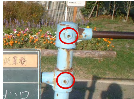
▲ 継ぎ手部分ボルト欠損
