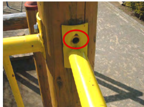
▲ 安全柵取り付け金具の欠落
