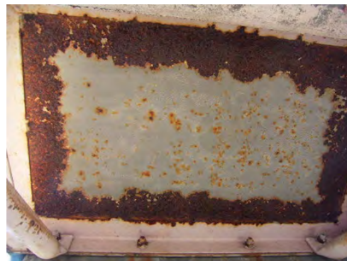
▲ 踊り場（裏側）の腐食
