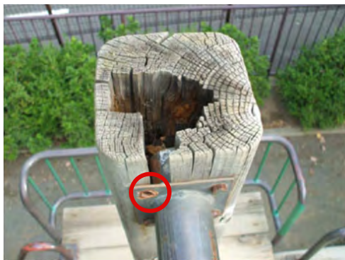
▲ 支柱天端の腐朽及びボルトの欠落
