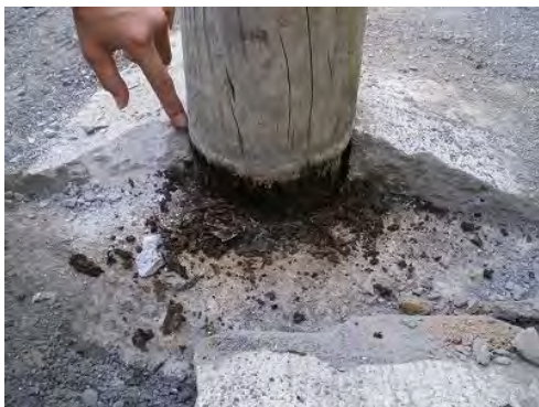
▲ 根際部の腐食（木製柱）
