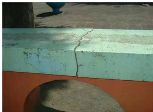
▲ コンクリートの亀裂
