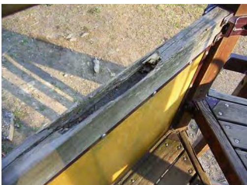
▲ 手すり部材の腐朽
