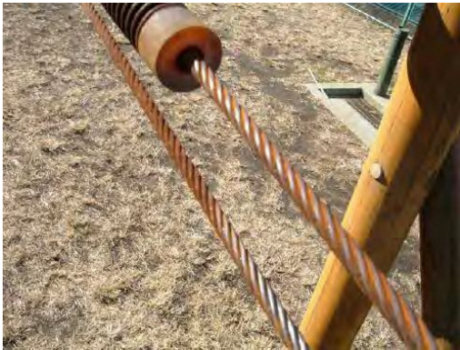
▲ ケーブルの腐食
