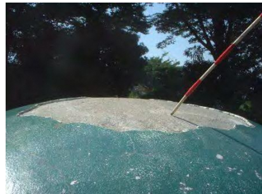
▲ モルタル部の破損
