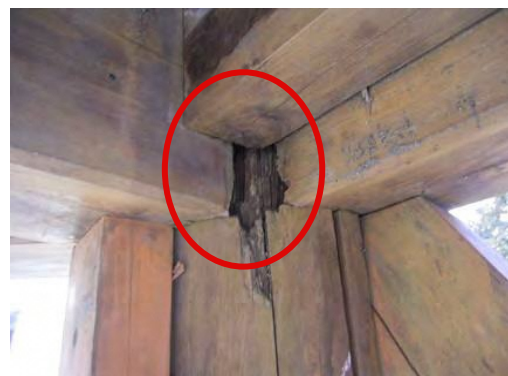
▲ 梁及び支柱の腐朽
