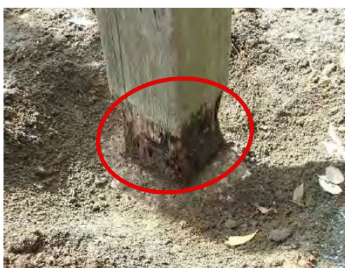
▲ 根際部の腐食（木製柱）
