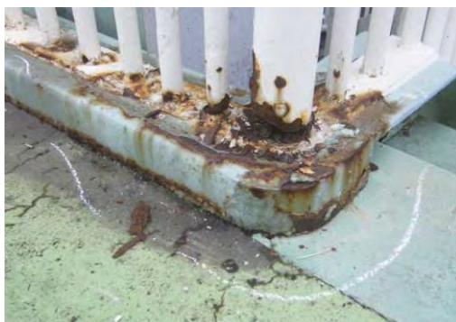
▲ 橋梁高覧（手摺り）の腐食
