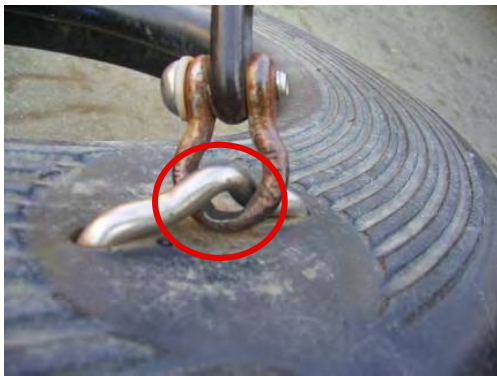
▲ 取付金具の摩耗
