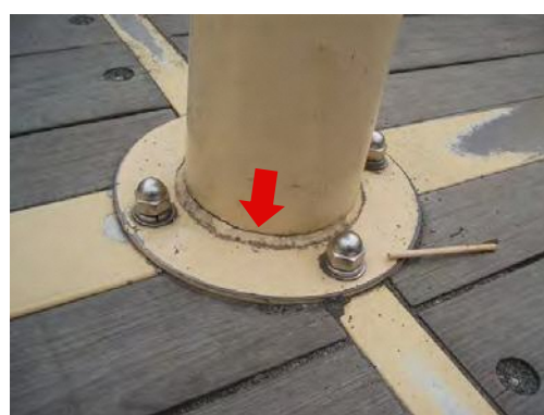
▲ フランジ溶接部の亀裂
