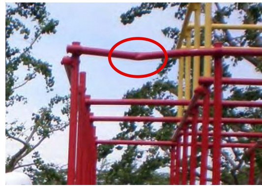
▲ 横部材の変形（曲がり）
