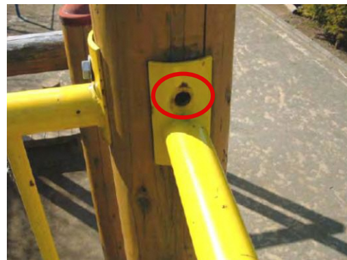
▲ 安全柵取り付け金具の欠落
