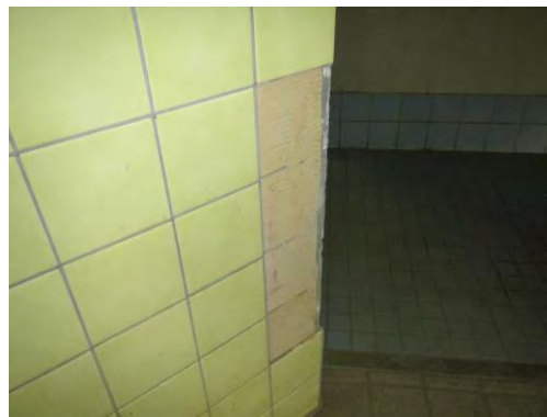
▲ 便所 壁面タイル破損
