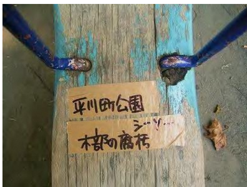
▲ 板の腐朽、取っ手のぐらつき
