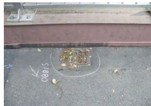
▲ 橋梁の排水施設土砂詰り
