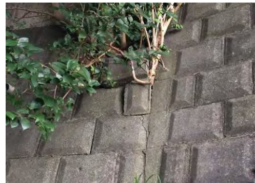
▲ 落下の危険があるブロック
