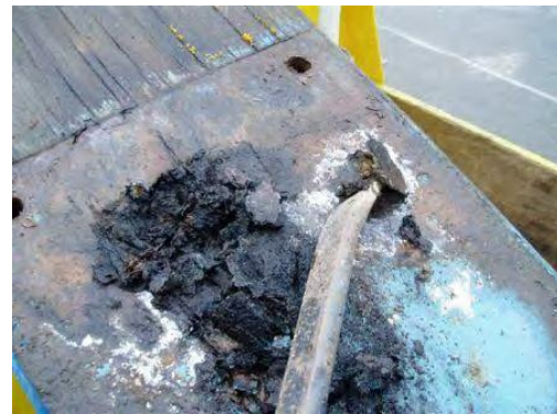
▲ 板の腐食状況
