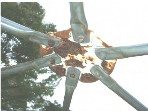
▲ 接続金具の腐食
