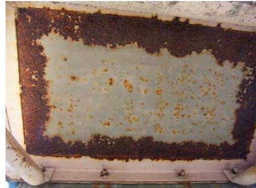
▲ 踊り場（裏側）の腐食
