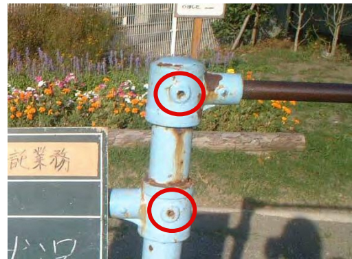
▲ 継ぎ手部分ボルト欠損
