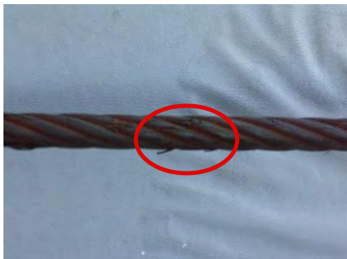
▲ ケーブルの摩耗（素線破断）
