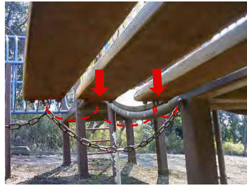
▲ 吊り橋下部ぶれ止めシャックル欠落
