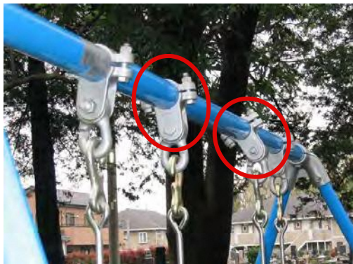
▲ 吊金具のずれ
