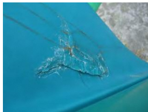
FRPの劣化状況
