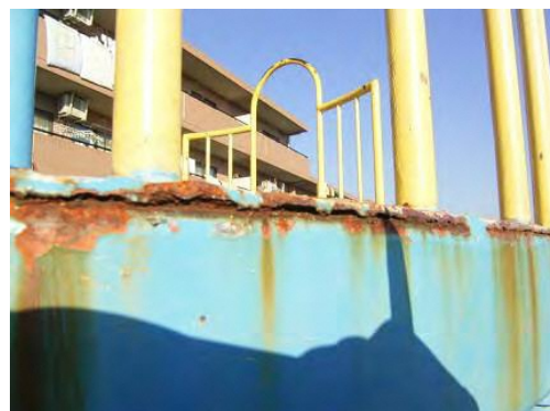
▲ 踊り場の腐食
