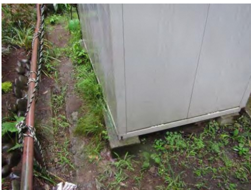
▲ 倉庫 基礎不良
