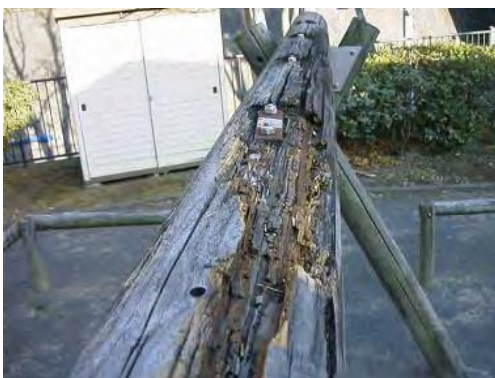
▲ ブランコ梁の腐食（木製）
