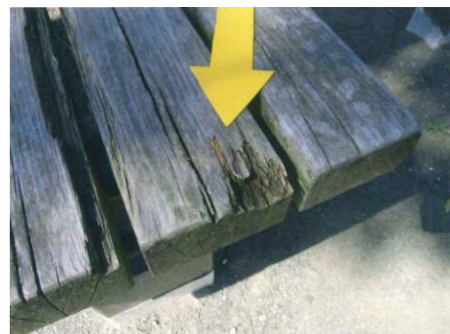
▲ 木製ベンチの腐食
