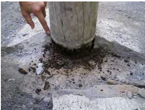
▲ 根際部の腐食（木製柱）
