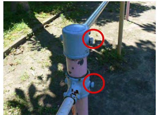
▲ ボルトの飛び出し
