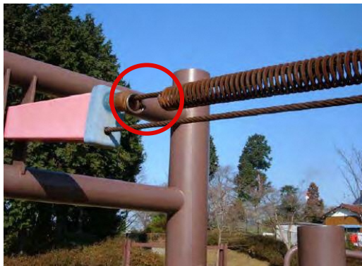
▲ 緩衝部（スプリング）の破損
