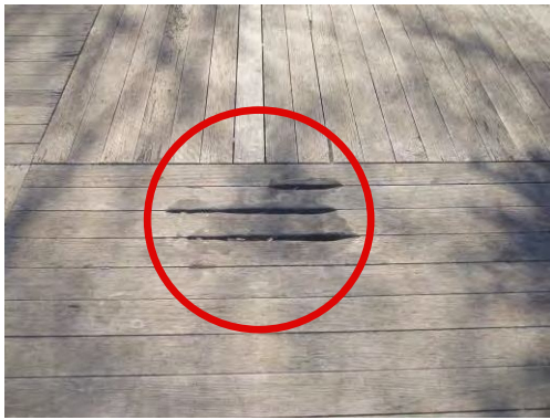
▲ 木製デッキ 床面破損（たき火あと）
