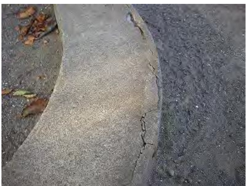
▲ 人研ぎ仕上げの割れ
