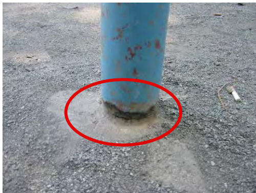
▲ 支柱地際部の腐食及び亀裂
