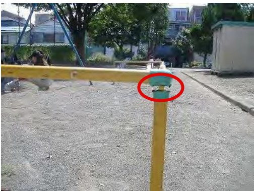
▲ ブランコ安全柵の継手金具の割れ
