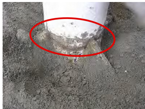
▲ 根際部の腐食及び亀裂
