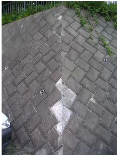
▲ 石積端部の化粧モルタル浮き (浮いたモルタルをはがした状態)
