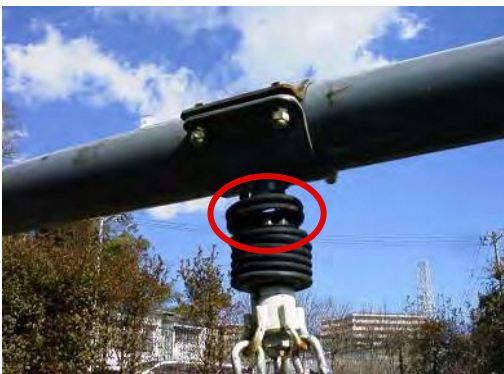
▲ 吊金具カバー破損
