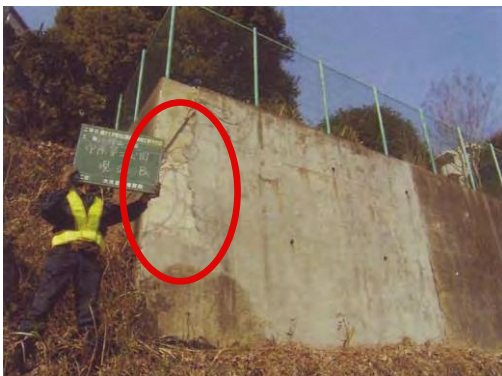
▲ 擁壁表面剥れ
