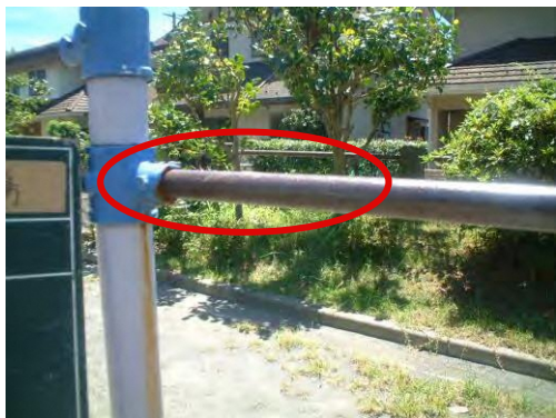
▲ 継ぎ手部分及び握り棒の錆
