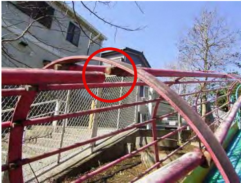
▲ 落下防止柵の接合部の破損
