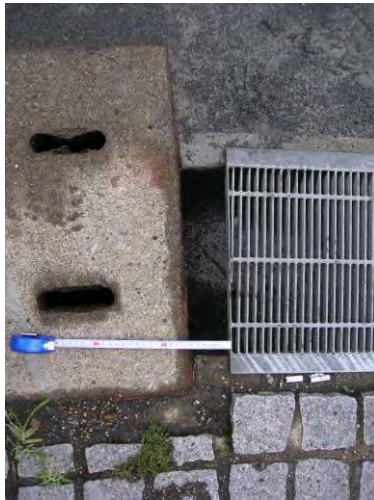
▲ グレーチング 隙間
