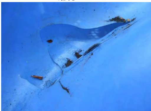
▲ スライダー滑降面の破損
