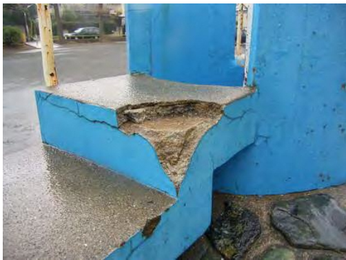
▲ コンクリートの破損
