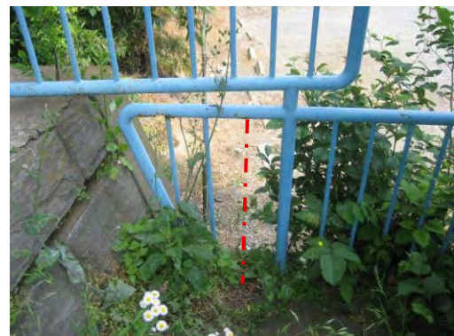
▲ 縦格子柵 部材欠損
