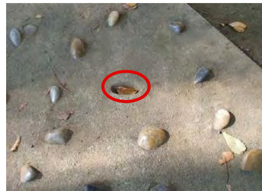
▲ 踏み石の欠落（健康歩道）
