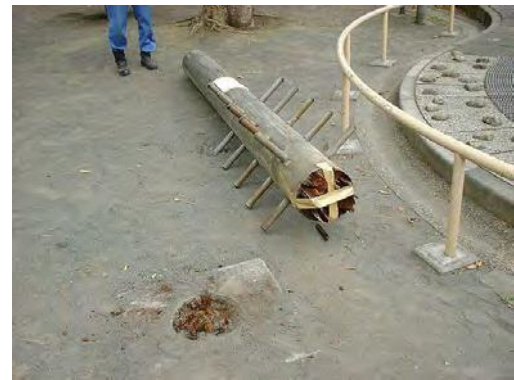
▲ 根際部の腐食による倒壊（木製柱）
