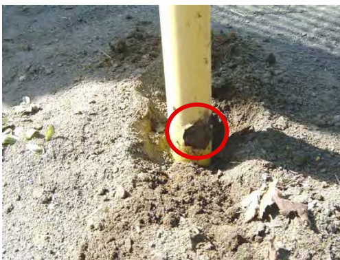
▲ 根際部の腐食（金属柱）
