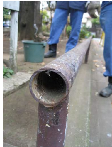
▲ パイプ柵 端部欠損
