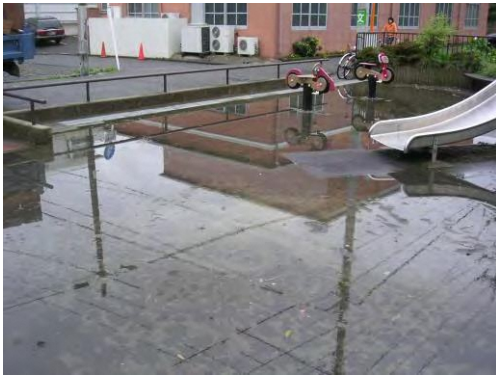
▲ 広場 排水不良
