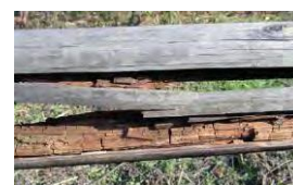
木材の腐朽(褐色腐朽)
