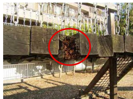
▲ 吊り橋部材の腐朽
