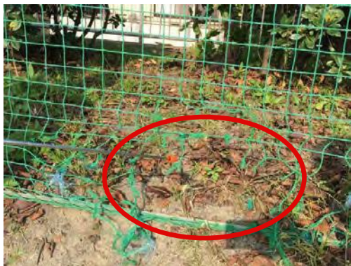
▲ 防球ネット ネット破れ
