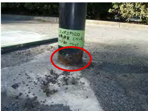
▲ あん馬ベンチ根際部の腐食（鋼製柱）
