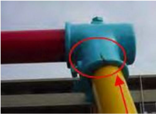
▲ 継ぎ手金具の割れ
