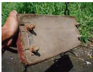
腐朽の初期段階
