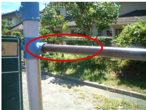
▲ 継ぎ手部分及び握り棒の錆
