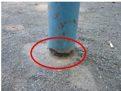
▲ 支柱地際部の腐食及び亀裂
