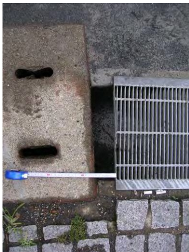
▲ グレーチング 隙間
