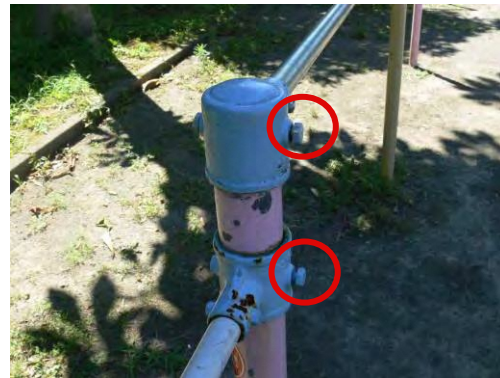
▲ ボルトの飛び出し
