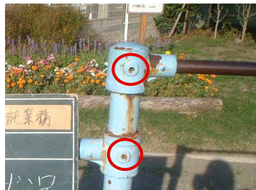
▲ 継ぎ手部分ボルト欠損
