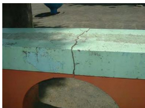
▲ コンクリートの亀裂
