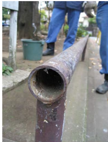
▲ パイプ柵 端部欠損
