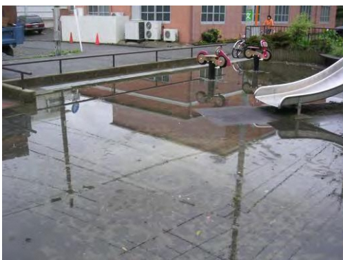
▲ 広場 排水不良
