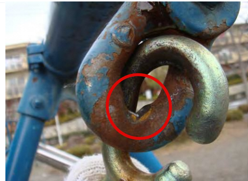
▲ 吊金具の摩耗
