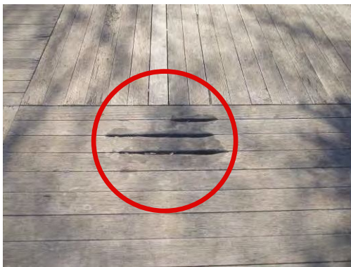
▲ 木製デッキ 床面破損（たき火あと）
