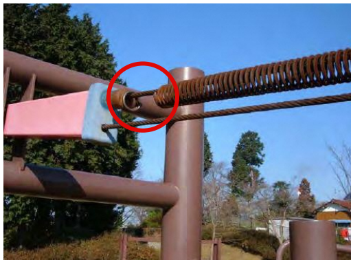
▲ 緩衝部（スプリング）の破損
