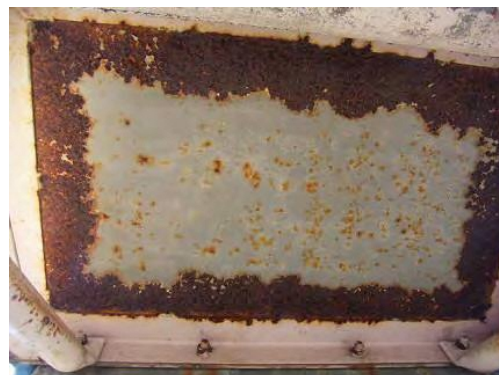
▲ 踊り場（裏側）の腐食
