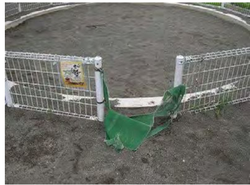
▲ 砂場柵入口の破損
