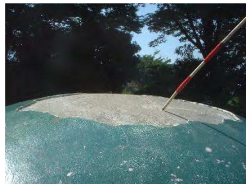
▲ モルタル部の破損
