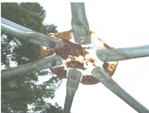
▲ 接続金具の腐食
