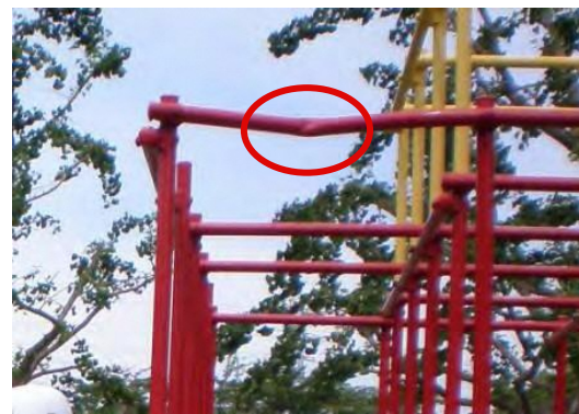
▲ 横部材の変形（曲がり）
