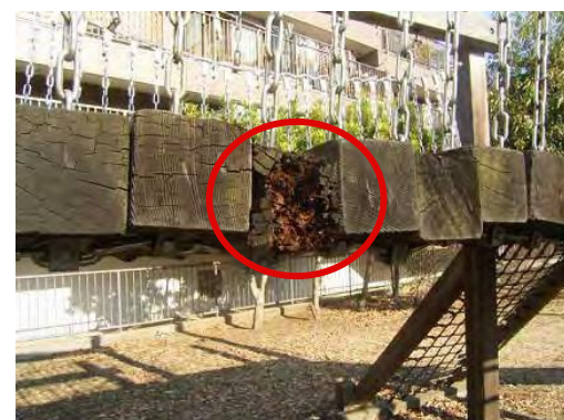
▲ 吊り橋部材の腐朽
