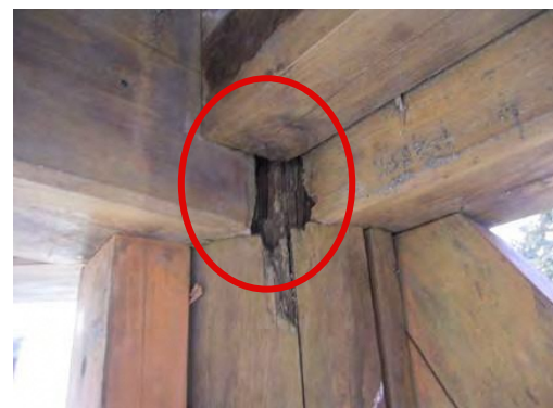
▲ 梁及び支柱の腐朽
