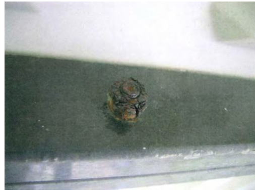
▲ パーゴラ ボルトさび
