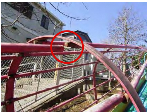
▲ 落下防止柵の接合部の破損
