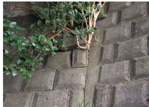
▲ 落下の危険があるブロック
