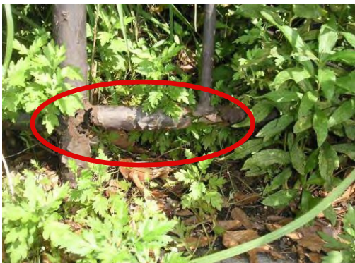
▲ パイプ柵 部材腐食
