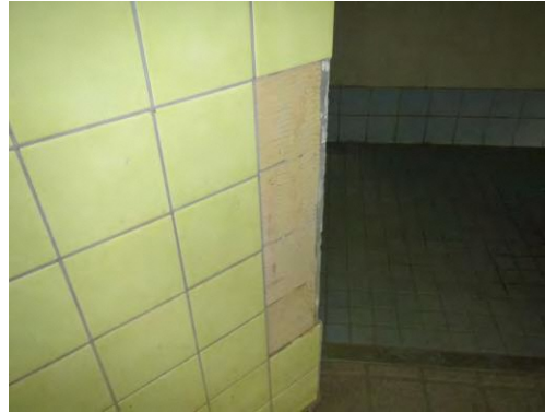
▲ 便所 壁面タイル破損
