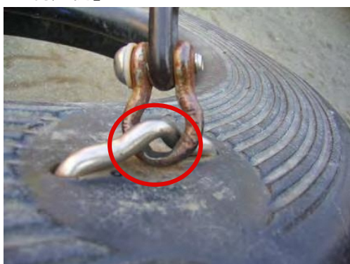
▲ 取付金具の摩耗
