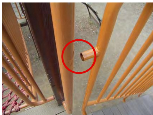
▲ 安全柵取り付け金具の脱落
