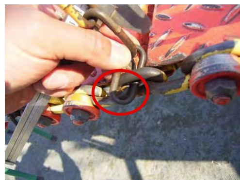
▲ 吊り橋チェーン摩耗
