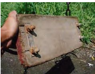
腐朽の初期段階
