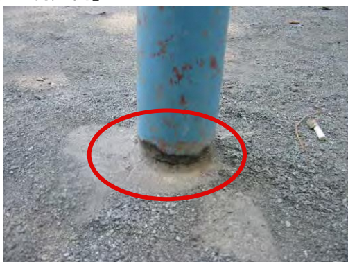
▲ 支柱地際部の腐食及び亀裂
