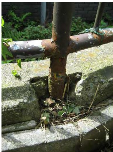
▲ パイプ柵 基礎破損
