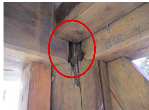
▲ 梁及び支柱の腐朽
