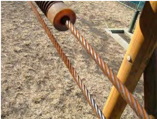
▲ ケーブルの腐食
