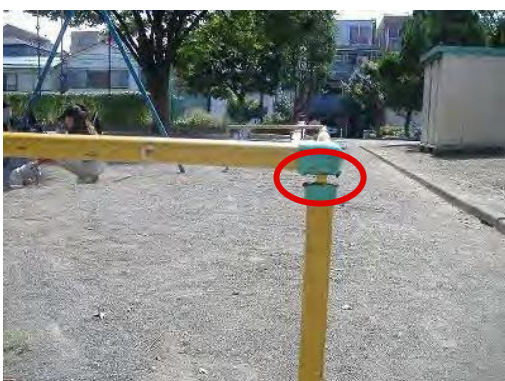
▲ ブランコ安全柵の継手金具の割れ
