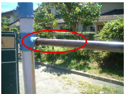
▲ 継ぎ手部分及び握り棒の錆
