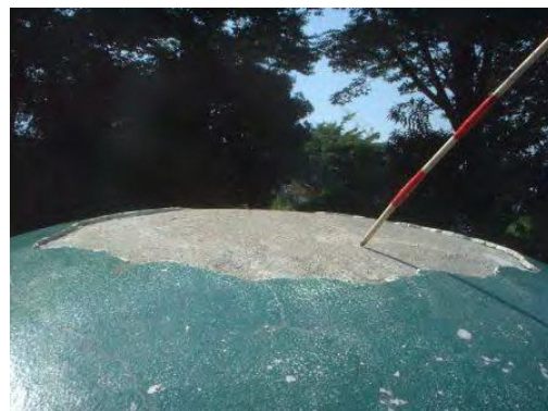
▲ モルタル部の破損
