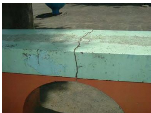
▲ コンクリートの亀裂
