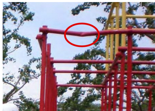
▲ 横部材の変形（曲がり）
