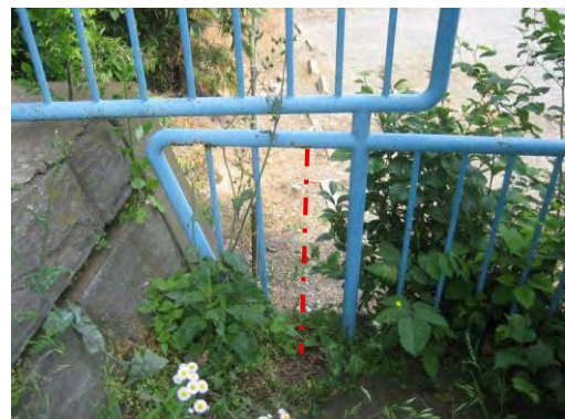
▲ 縦格子柵 部材欠損
