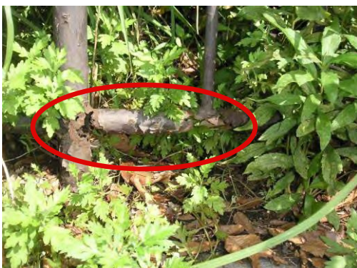
▲ パイプ柵 部材腐食
