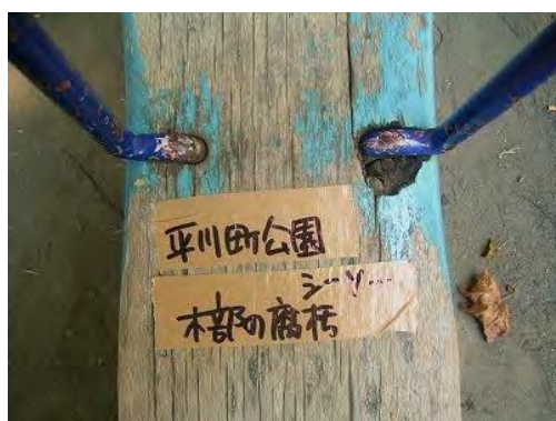
▲ 板の腐朽、取っ手のぐらつき
