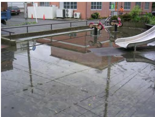
▲ 広場 排水不良
