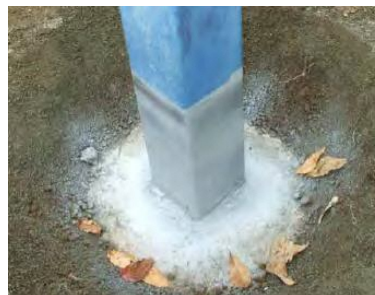
◀ 柱の根際部の 防食テープ 措置事例
