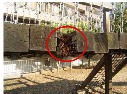
▲ 吊り橋部材の腐朽
