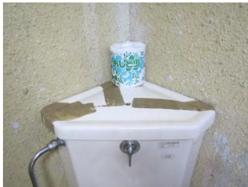
▲ 便所 タンク蓋破損
