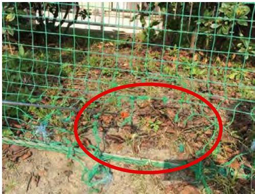
▲ 防球ネット ネット破れ
