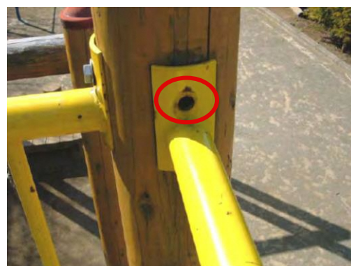
▲ 安全柵取り付け金具の欠落
