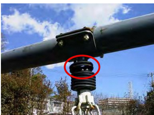
▲ 吊金具カバー破損
