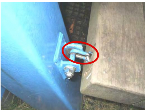
▲ 吊り橋取り付け部チェーンの摩耗
