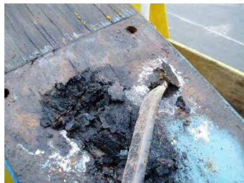
▲ 板の腐食状況
