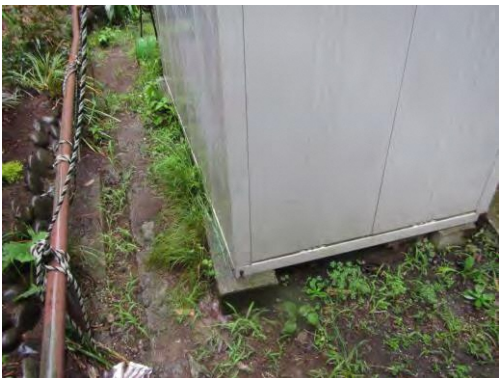
▲ 倉庫 基礎不良
