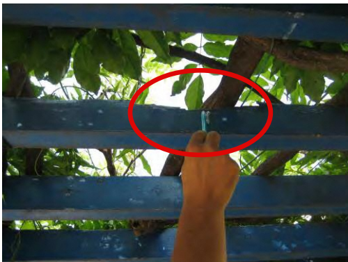
▲ パーゴラ 桟木腐食
