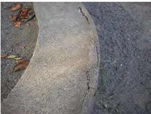
▲ 人研ぎ仕上げの割れ
