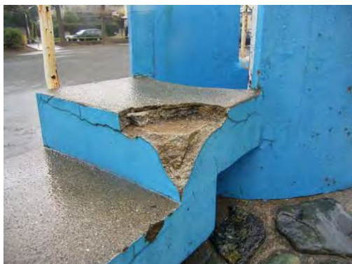
▲ コンクリートの破損
