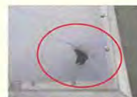
〈旭プール 吹き抜け部雨漏り〉
