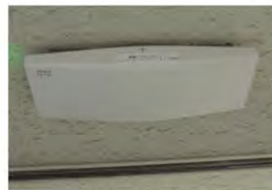
大会役員室前に Wi-Fi ルーターを設置
