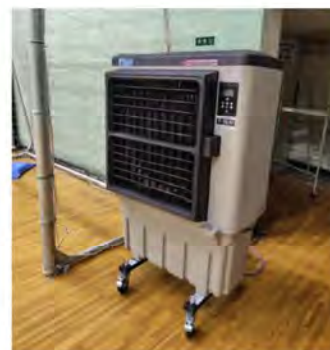
「大型冷風式扇風機」を設置済
