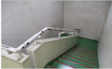
階段付近の床壁の劣化
