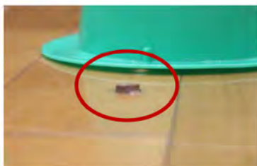
床不良の一例 - ダボ浮き
