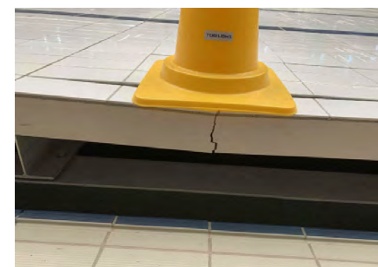
メインプール床のひび割れの状況
