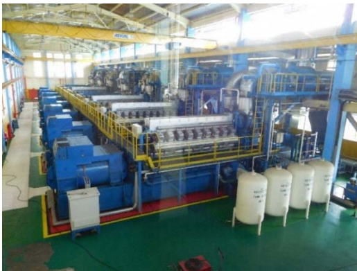
バタミンド工業団地のガス発電施設
