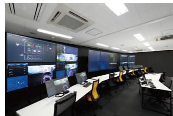
遠隔監視室 Remote Monitoring Room
