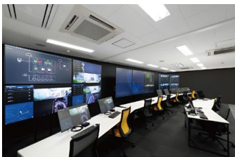
遠隔監視室 Remote Monitoring Room
