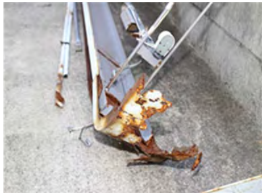
袖看板①（錆びた底板）
