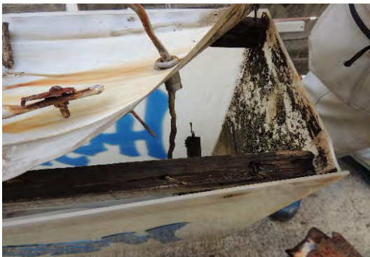
袖看板② （内部の木骨が腐食している状態）
