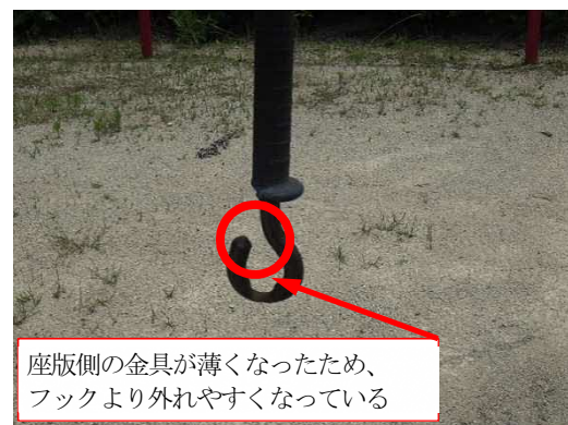
事故発生状況
