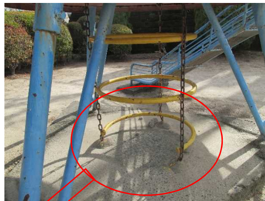
コンクリートの露出状況
