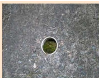
②水抜き穴のつまり
