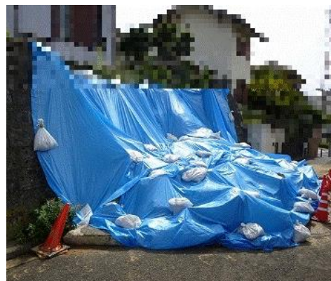
擁壁が崩壊した事例
