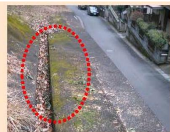
①排水溝のつまり
