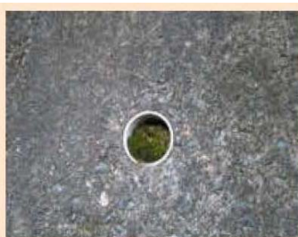
②水抜き穴のつまり
