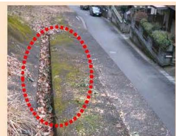
①排水溝のつまり
