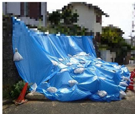
擁壁が崩壊した事例
