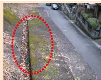
①排水溝のつまり
