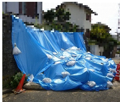
擁壁が崩壊した事例
