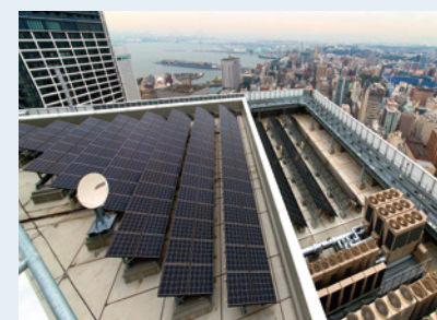
市庁舎に設置した太陽光パネル
