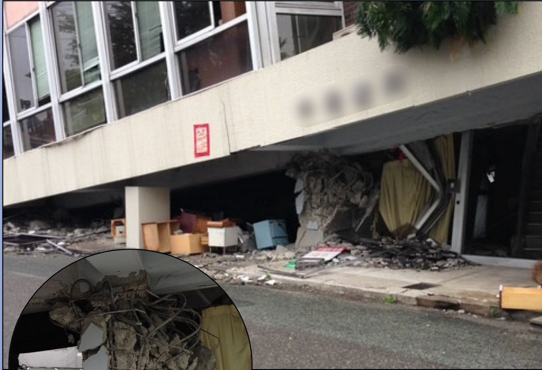
(上)熊本地震にて倒壊した建築物(熊本市) (左)倒壊した建築物の柱
