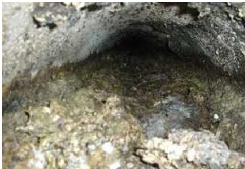
配管のつまり（油脂類）
